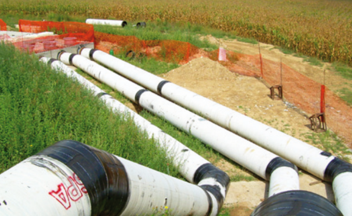
Impianto di sollevamento acque di bonifica – Torri di Quartesolo (VI)
