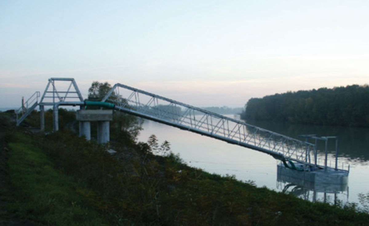
Impianto di pompaggio galleggiante per potabilizzatore sul fiume Po
