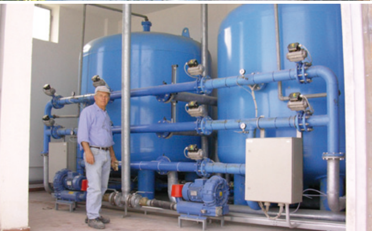
Impianto di filtrazione a sabbia in pressione – Isole Tremiti (FG)
