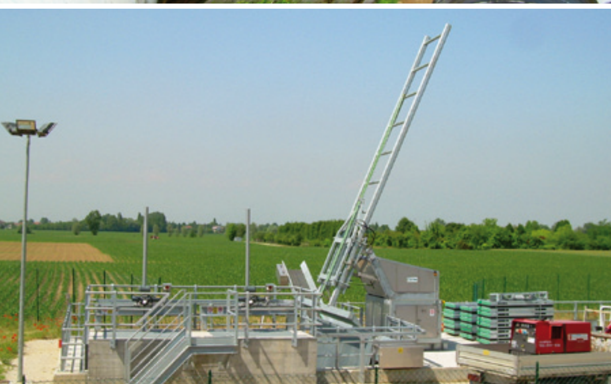
Impianto di sollevamento acque di bonifica – Torri di Quartesolo (VI)
