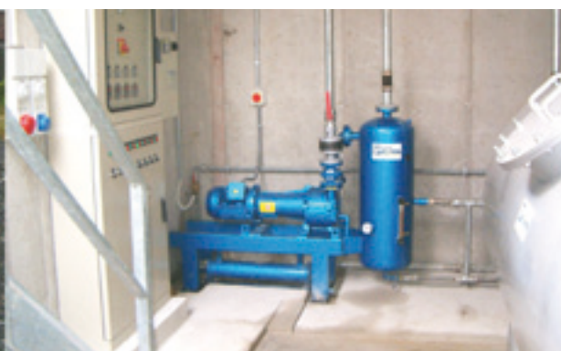
Impianto di fognatura sotto vuoto – Ramo di Palo (RO)
