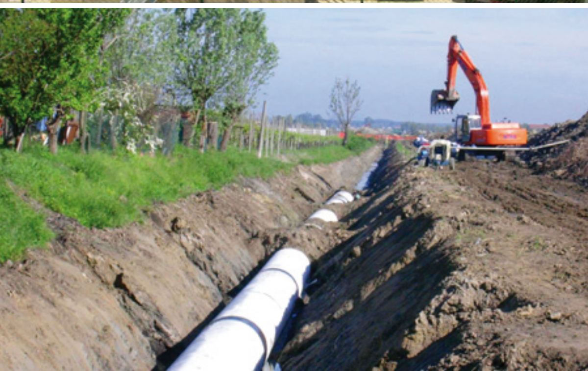
Impianto di sollevamento acque di irrigazione – Villadose (RO)
