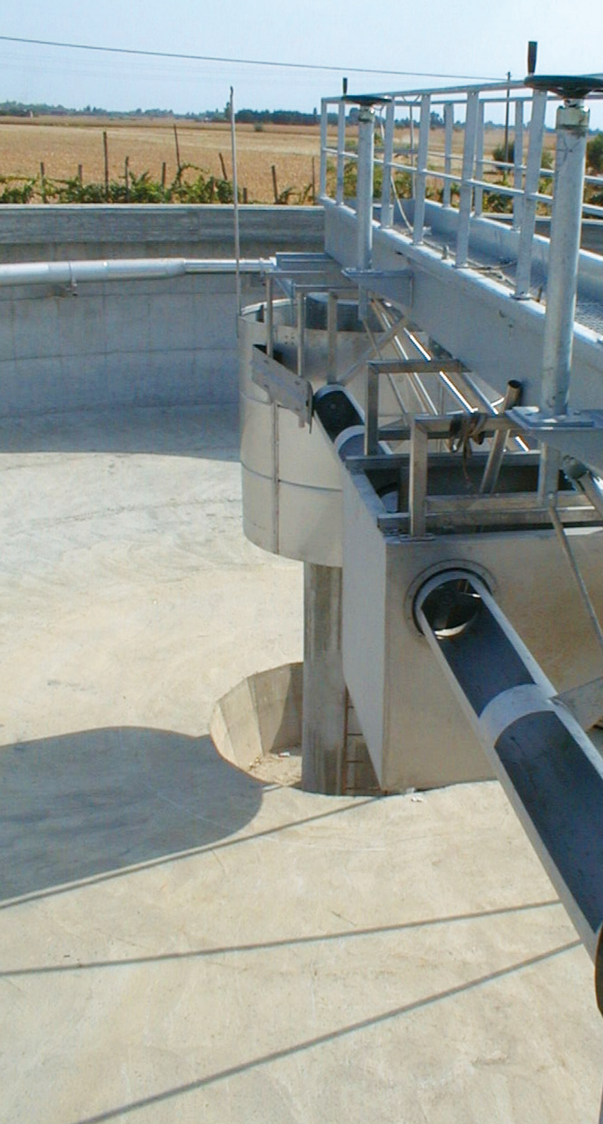
05-071 Dettaglio rotolung per rimozione schiume.
